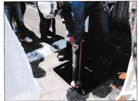
スタンドパイプを吐水口に差し込む
